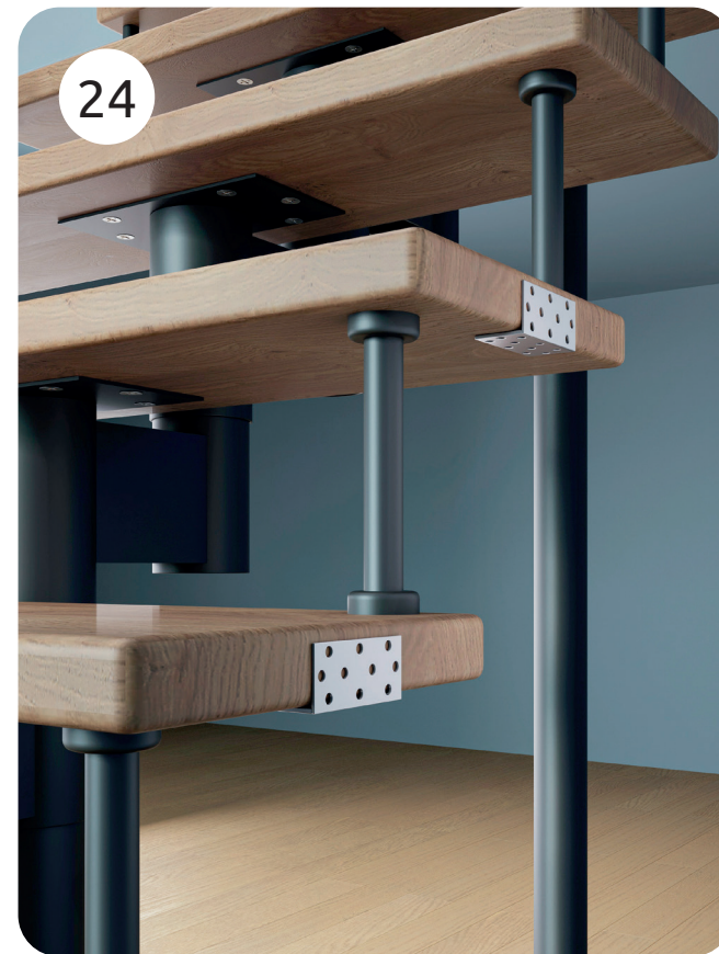
24. Дополнительно фиксируем ступени и площадки уголками к стене, для снятия нагрузки на край ступеней и площадок.
